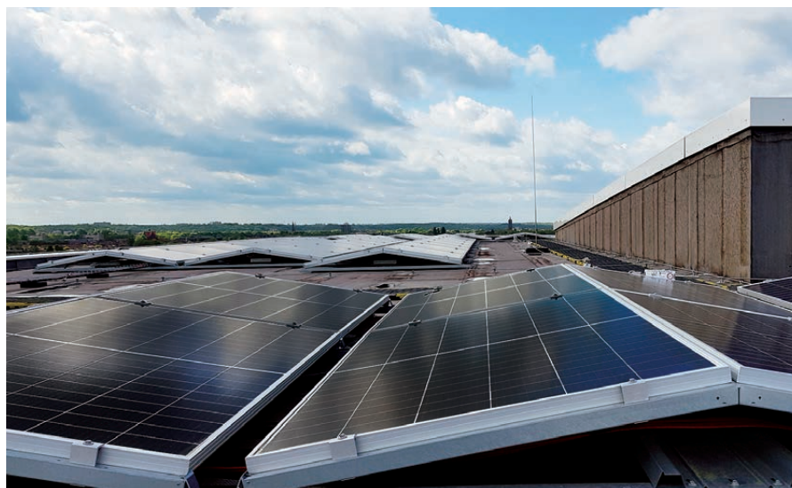
Panneaux solaires chez Canon Production Printing Netherlands
